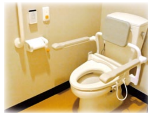
【車椅子対応のトイレスペース】
